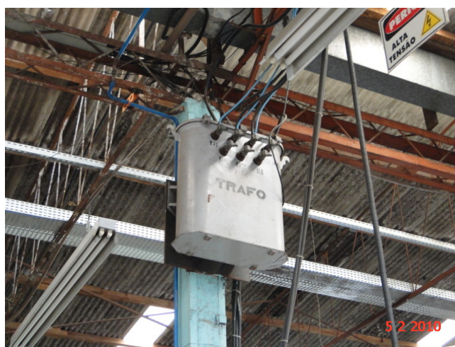
ITEM 113 – TRANSFORMADOR 60 KVA
