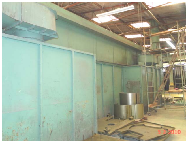
ITEM 87 – CABINE DE PINTURA
